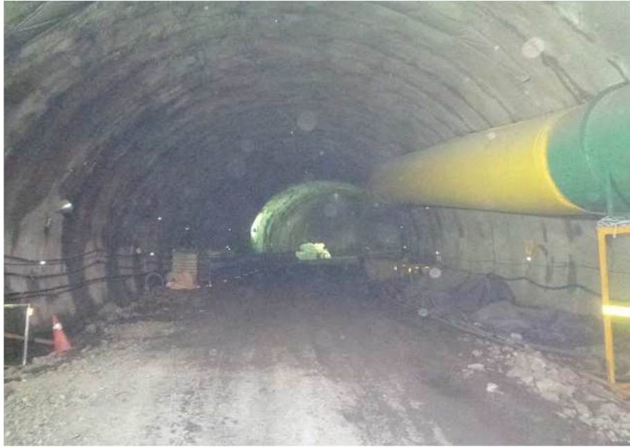
STA 0+610 ~ 0+871 공사중 환기시설 현황
