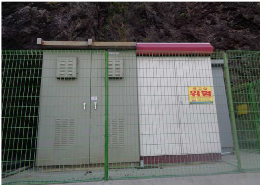
외부 전기시설 전경
